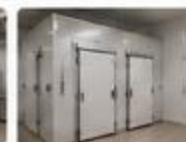
Chambre froide négative Distribution - Cameroun
